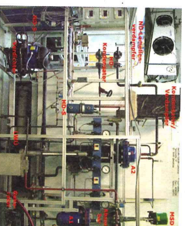
Bild 6: Ansicht der Kompressions-Absorptions-Kaskadenkälteanlage vor der Teflkühlzelle
